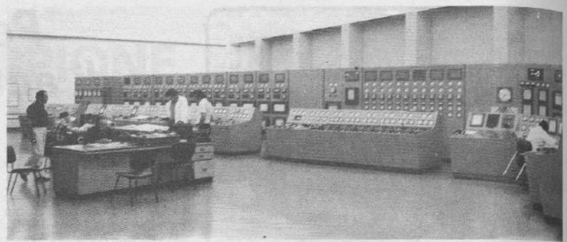
Sala controllo di una centrale nucleare
